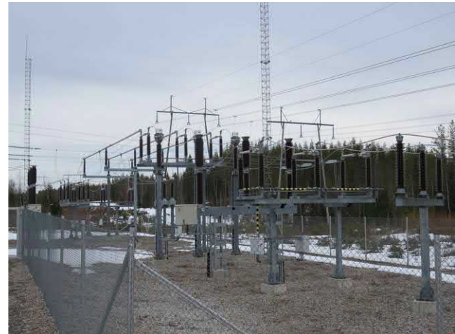
Kuva 41. Sähköasema Ukonmurron pohjoispuolella.
